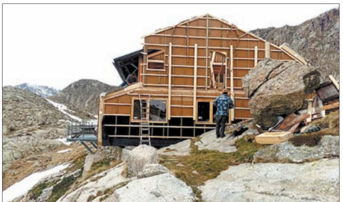
FOTO: Marta Lluvich (ACN) / Imatge de les obres d'ampliació. El refugi fou construït fa un segle
