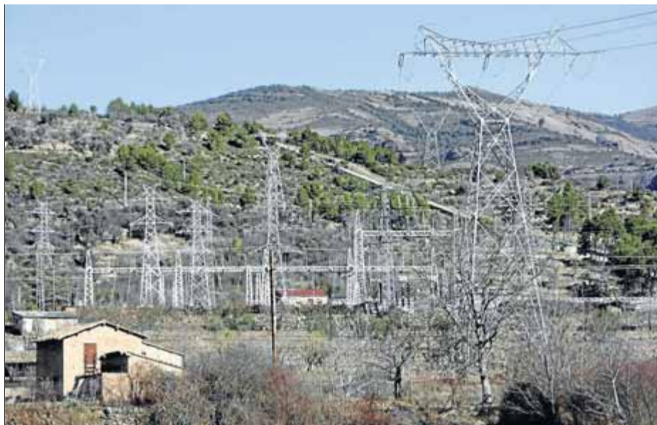
Estació elèctrica de la Pobla de Segur ■ ACN
