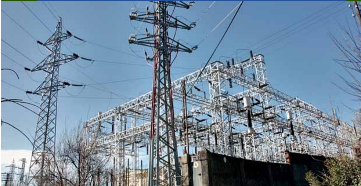
L'estació elèctrica de la Poble de Segur. L'autopista elèctrica és, per la plataforma, un atemptat contra la salut ■ ACN
