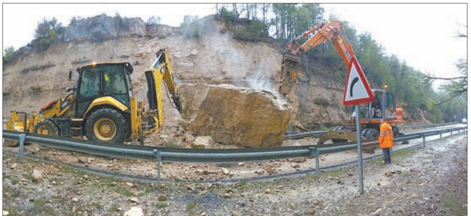
FOTO: Aj.Olius / Imatge del despreniment que es va registrar el dia 11 d'abril a la carretera C-26 al seu pas per Olius, al Solsonès
