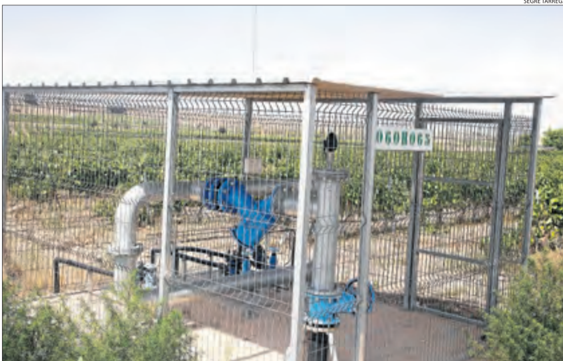
Instal·lacions de regadiu de la xarxa secundària del Segarra-Garrigues al municipi de Verdú.
