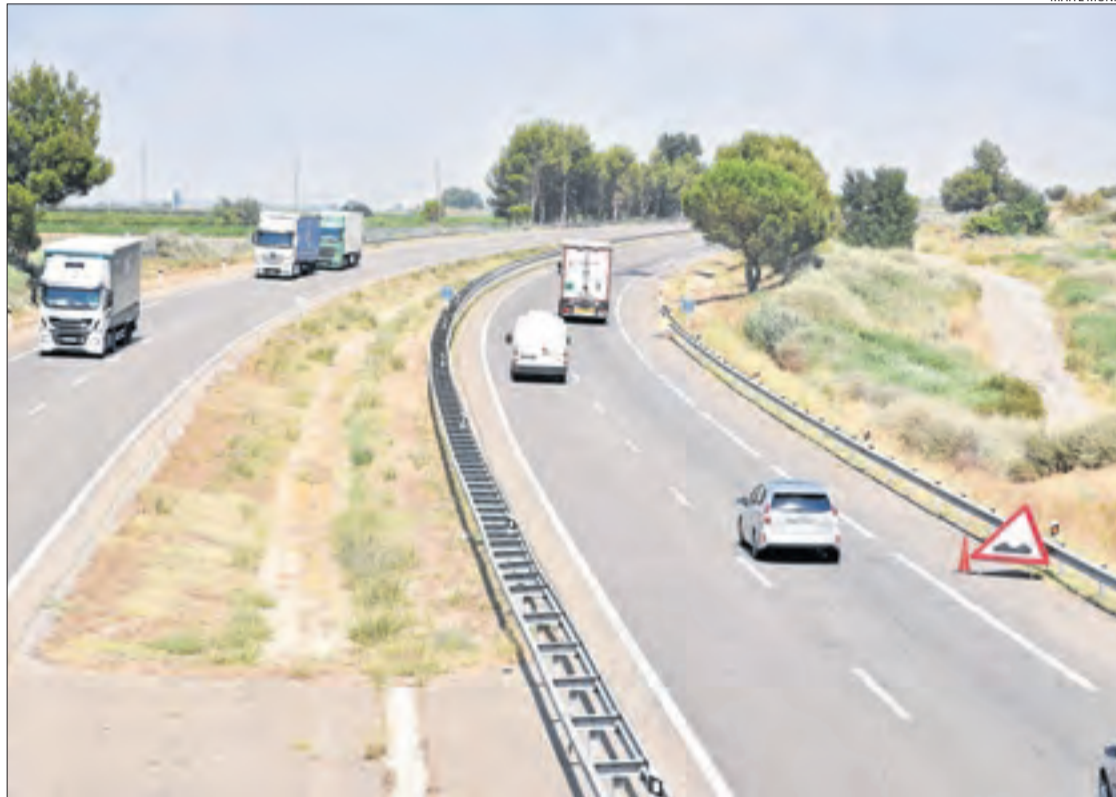
Un tram de la variant a prop dels Alamús, on senyals provisionals adverteixen sobre desperfectes.
