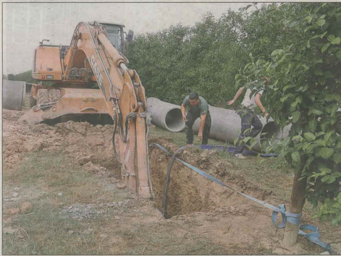
FOTO: ACN / Una màquina excavadora fent un pou en una finca per trobar aigua per regar els arbres fruiters
