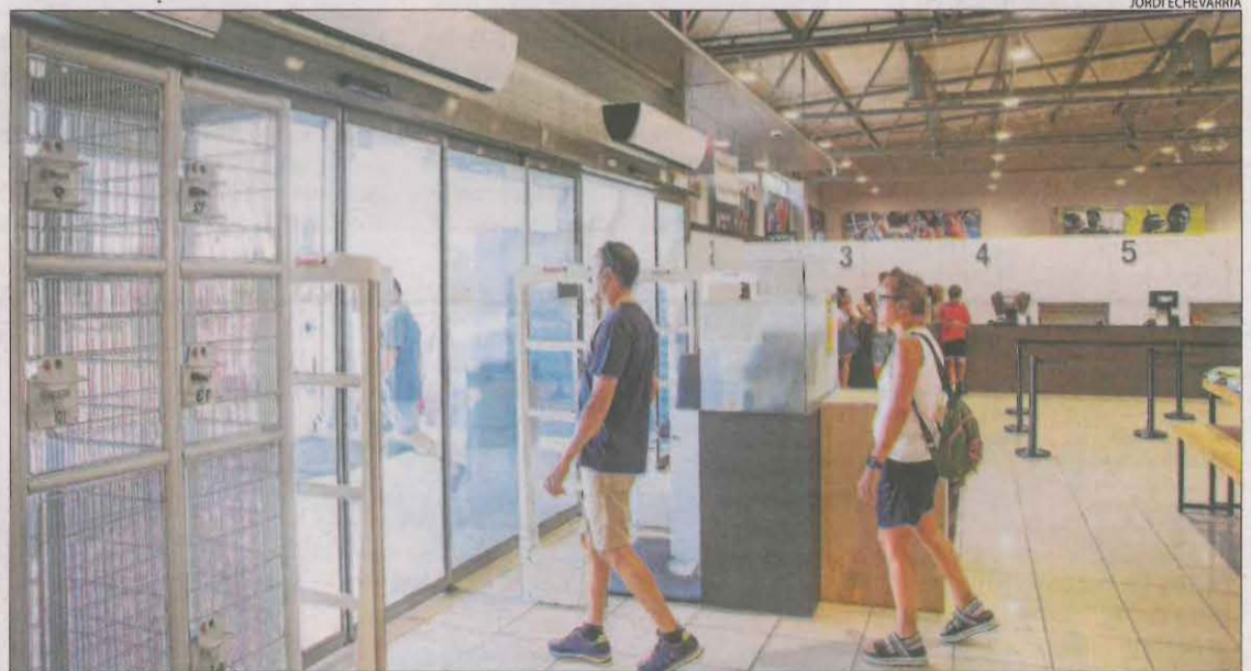
Clients del Wala de Lleida, davant dels aparells d'aire condicionat a la sortida de l'establiment.
