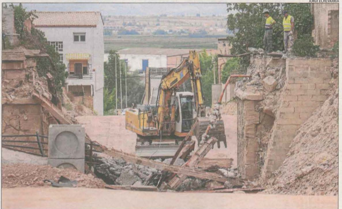
Els treballs per demolir el pont del carrer Lleida que salvava l'antic traçat del Carrilet.
