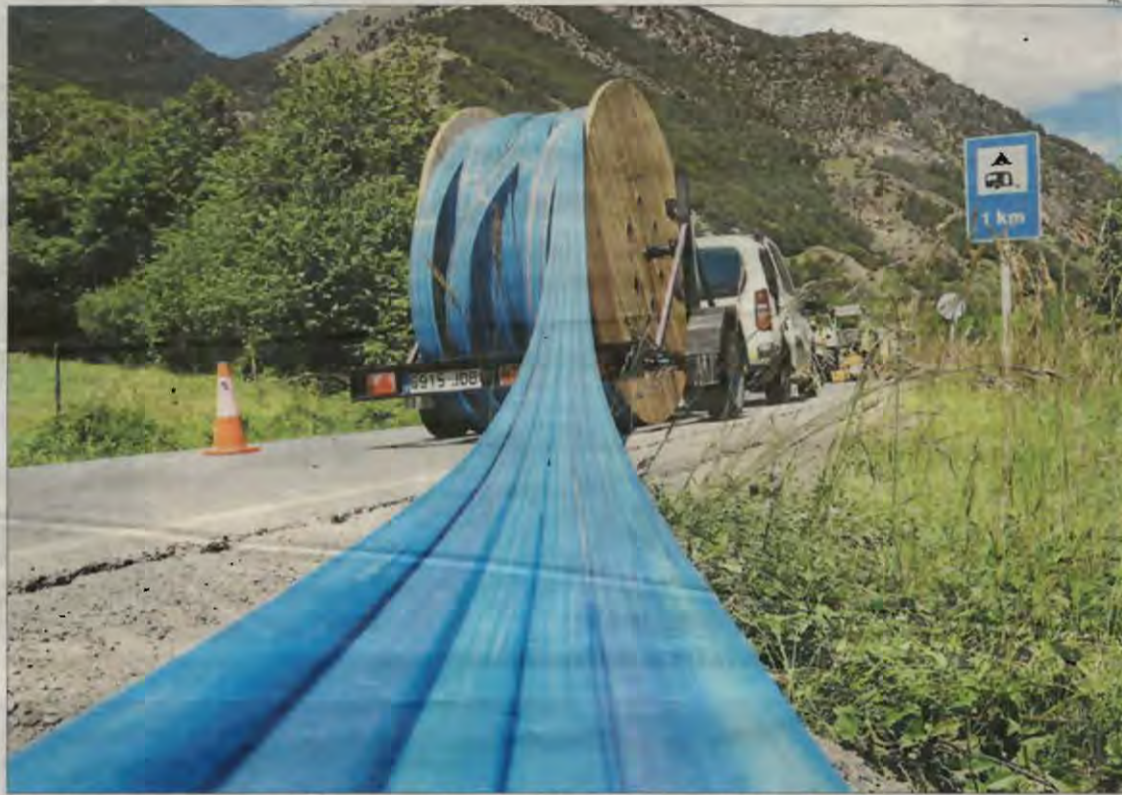
Imatge d'arxiu d'obres de cablatge de fibra al Pallars Sobirà, a la carretera C-13 a Llavorsí.
